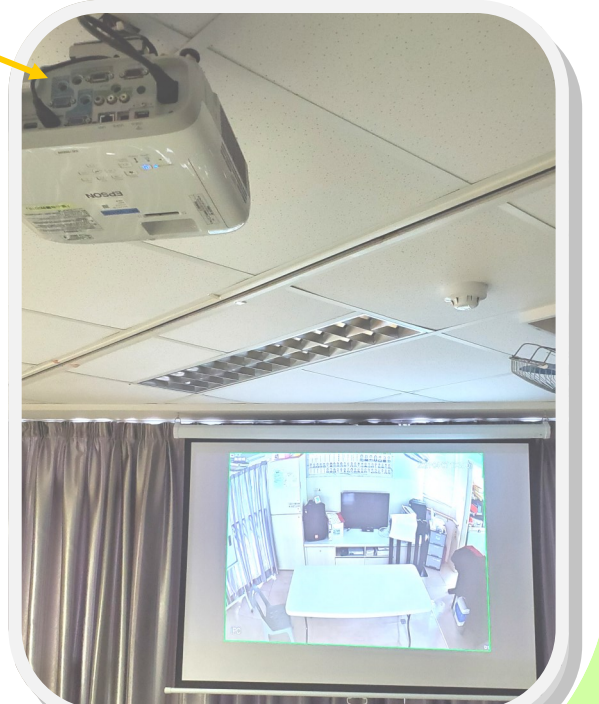
安裝在二樓天花的轉播系統
